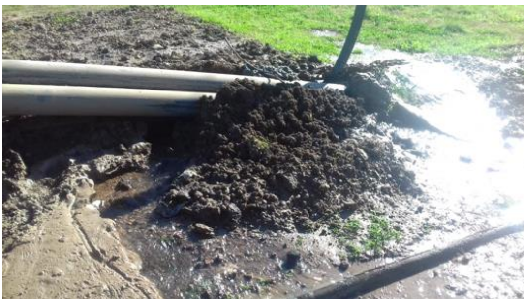
Imagen 1. Cañerías de agua rotas en el barrio.
